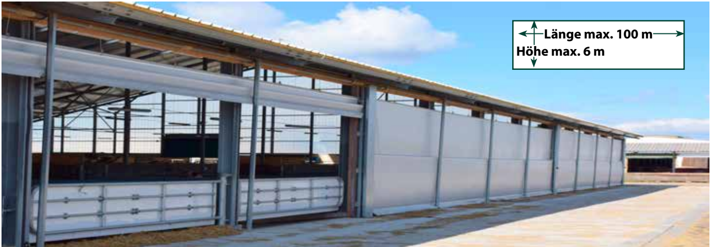
Seitenwandaufrolltechnik links komplett geöffnet und nach oben gefahren; rechts geschlossen
